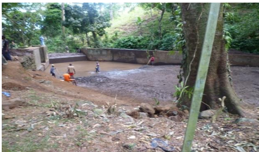
Figure 28 Envasement des captages
